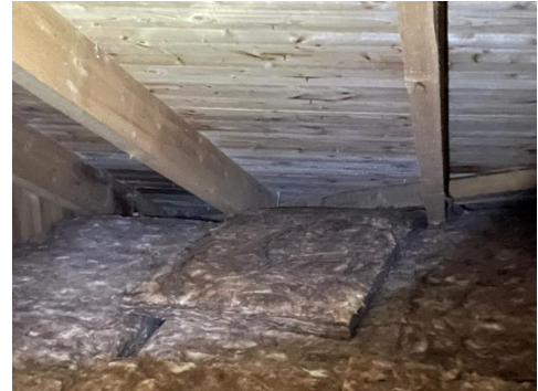
Fuktskjolder på deler av taktroden til takoppløftet.
