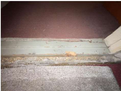
Skada dørterskel til vaskerommet.
